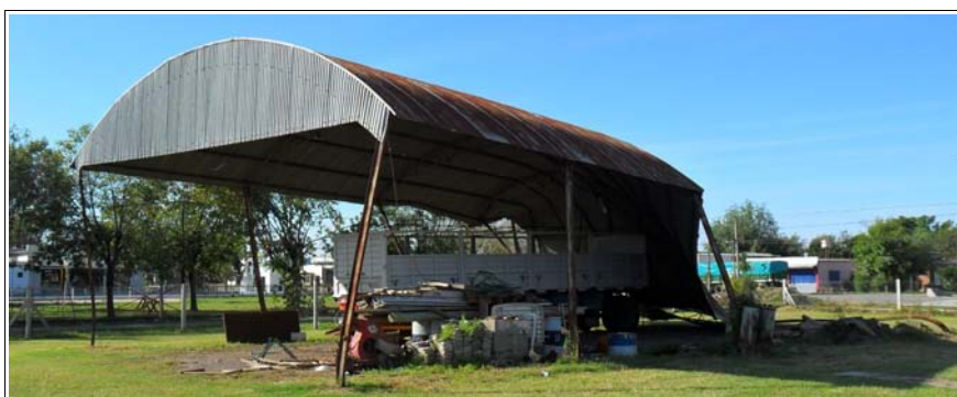
Figura 2: Cubierta aislada colapsada, tormenta 05-4-2012.
